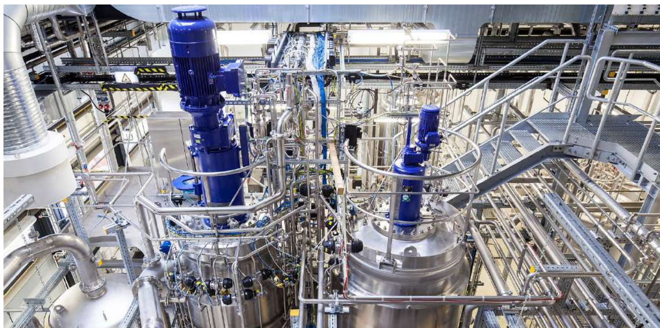
Démonstrateur industriel de Global Bioenergies installé à Leuna
