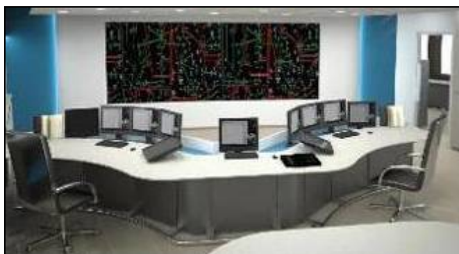
Poste de contrôle commande
