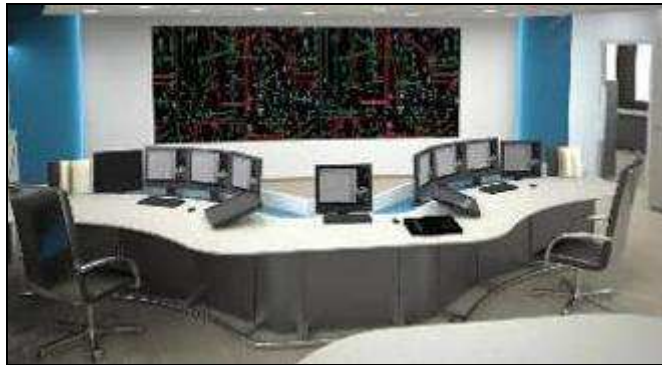
Poste de contrôle commande
