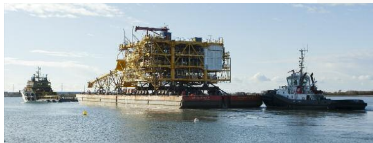
Départ de la cargo-barge Viking 3, remorquée par l'Amber 2, pour le Gabon. Construction de la plate-forme et du pont AGMN sur le chantier Eiffage. Projet de re-développement Anguille, Fos-sur-Mer, France. ▼
