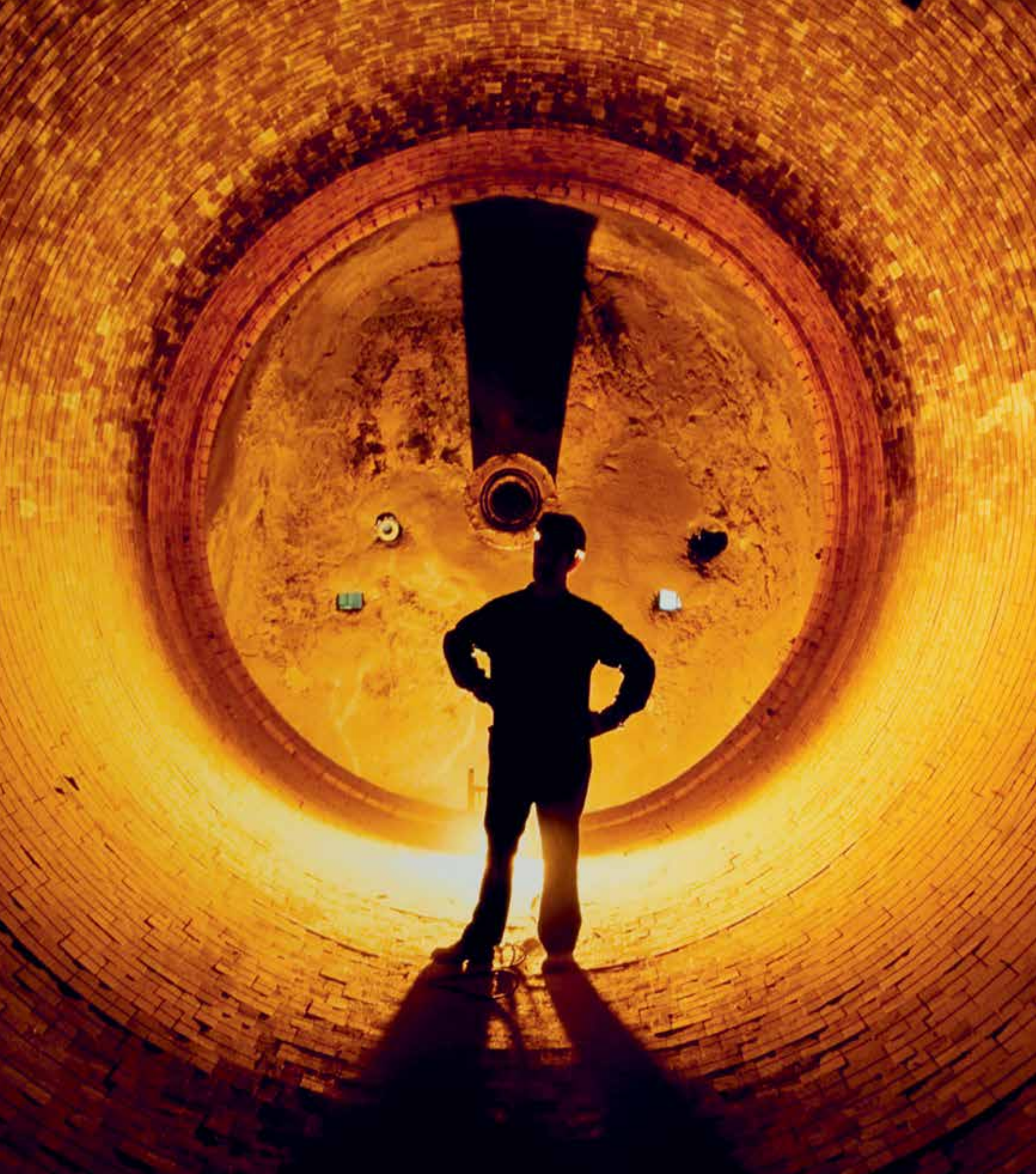
Vue de l'intérieur d'un four de cimenterie avant allumage de la flamme.
