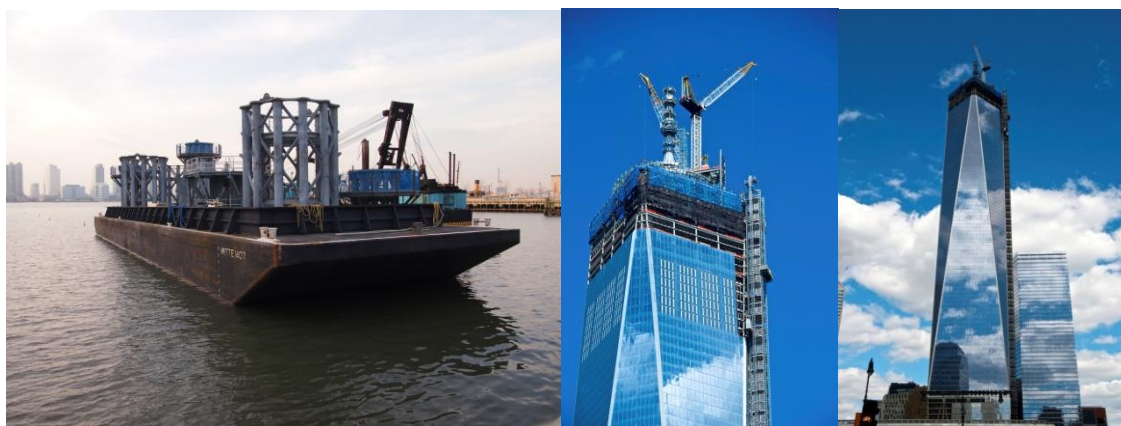
La touche finale du One World Trade Center : la flèche faite de tubes Vallourec
