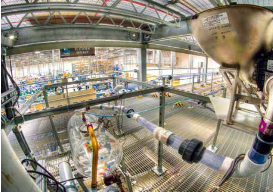
Banc d'intégration des systèmes eau et déchets d'avion à la division Zodiac Water & Waste Systems (Carson, Californie).
