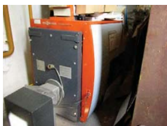
Chaudière existante au fioul
