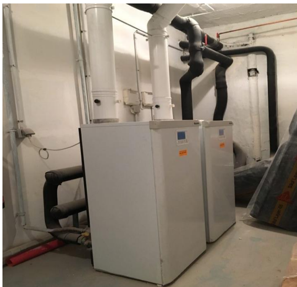
Chaudière à condensation - Le Vésinet (siège d'ARTEA)
