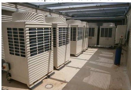
Pompes à chaleur réversible
