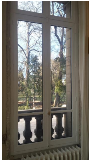
Menuiseries extérieures double vitrage installée en 2016
