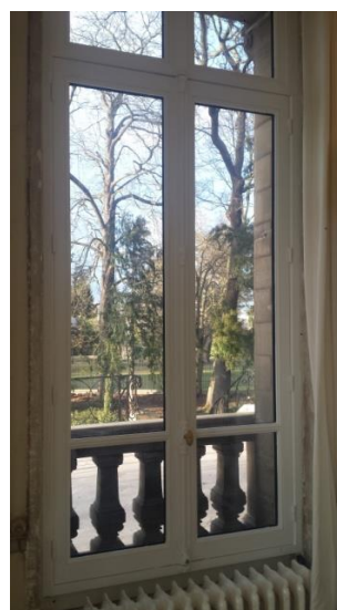
Menuiseries extérieures double vitrage installée en 2017
