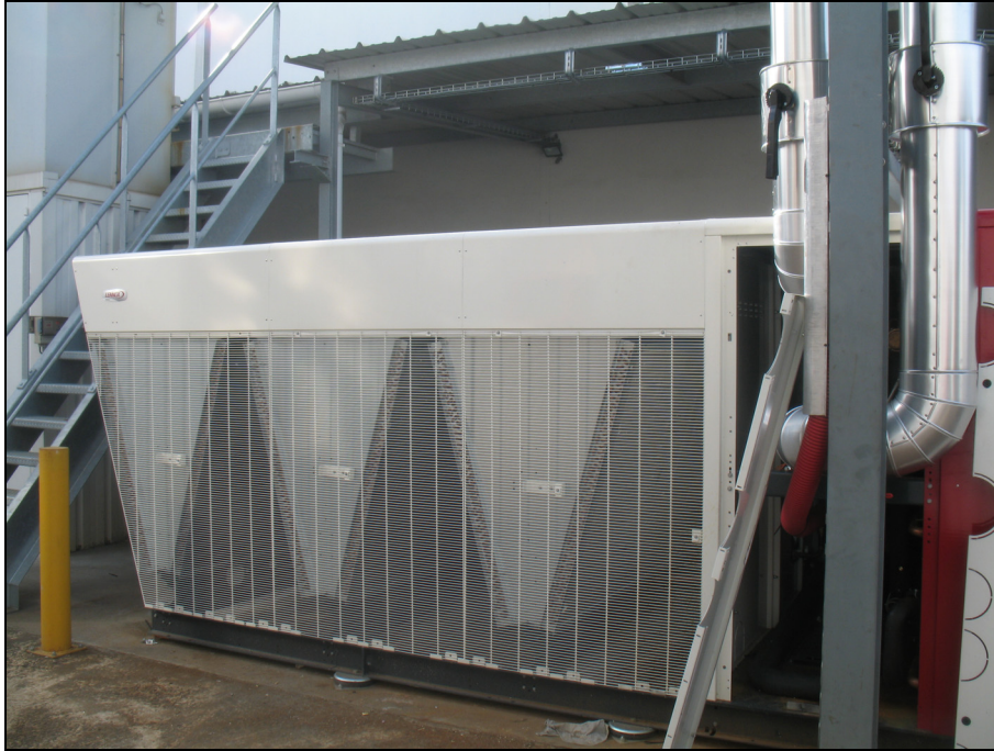
Pompe à chaleur – QUO-VADIS
