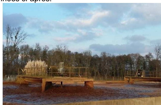
Station d'épuration de l'usine MARIE à Chacé (49)
