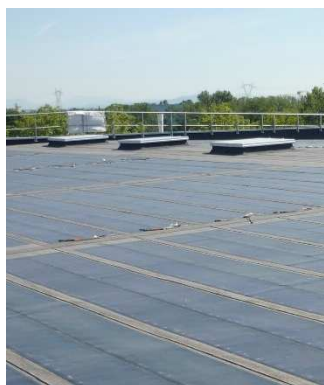
Panneaux photovoltaïques sur le site AGIS à Avignon (84)
