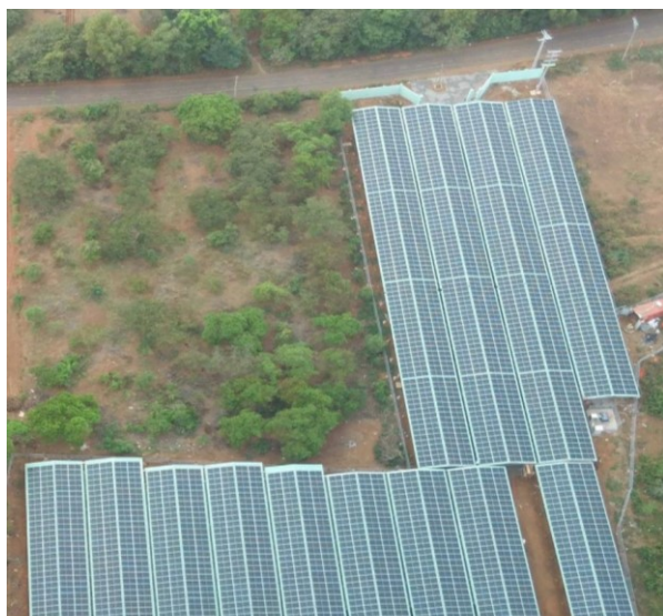
Installation solaire de 900 kWc dans une ferme de champignons vietnamienne, monitorée et gérée par la connectivité LoRaWAN.
