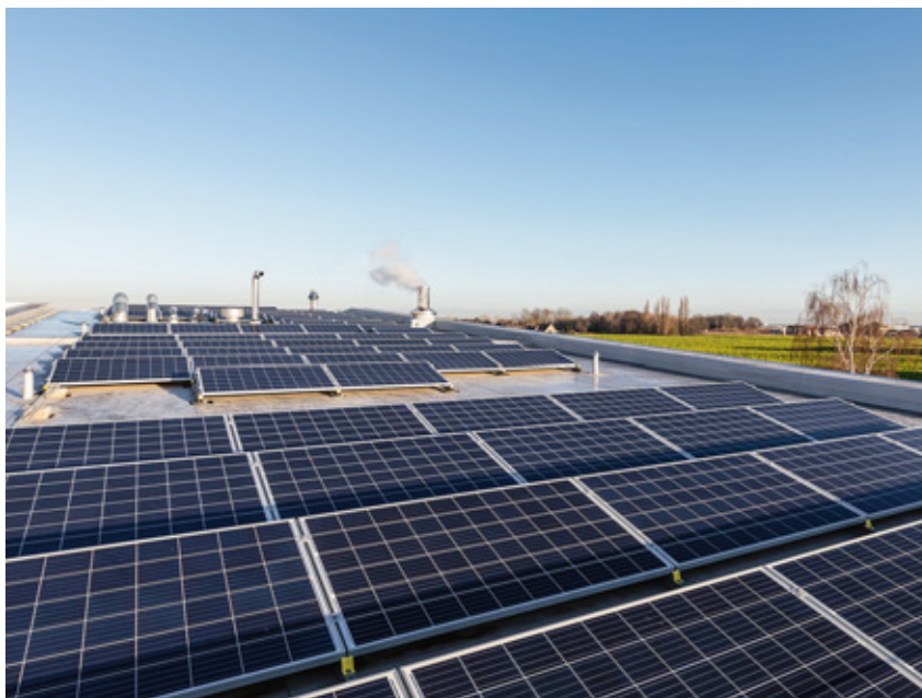
Neutralité carbone des opérations en 2025 : recourir massivement aux énergies « vertes » via l'installation d'équipements sur les sites
