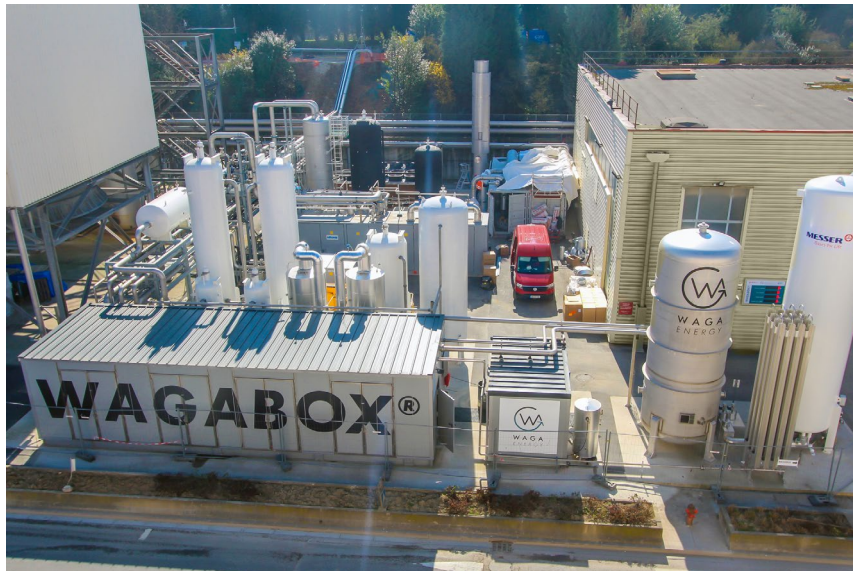
Unité de production de biométhane installée sur le pôle d’écologie industrielle opéré par Veolia, situé à Claye-Souilly.
