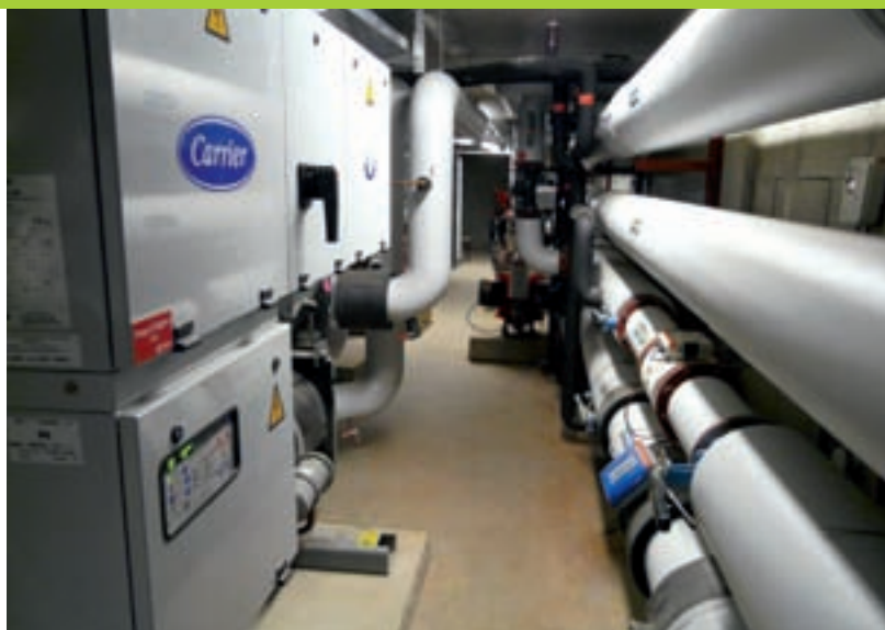
Hélianthe : pompes à chaleur géothermiques.
