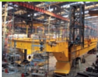
Le pont polaire de l'EPR d'Olkiluoto est en place Construction d'un des ponts polaires de Taishan qui s'inscrivent dans la lignée de celui d'Olkiluoto en Finlande, avec des difficultés supplémentaires telles que la prise en compte d'effets sismiques importants.
