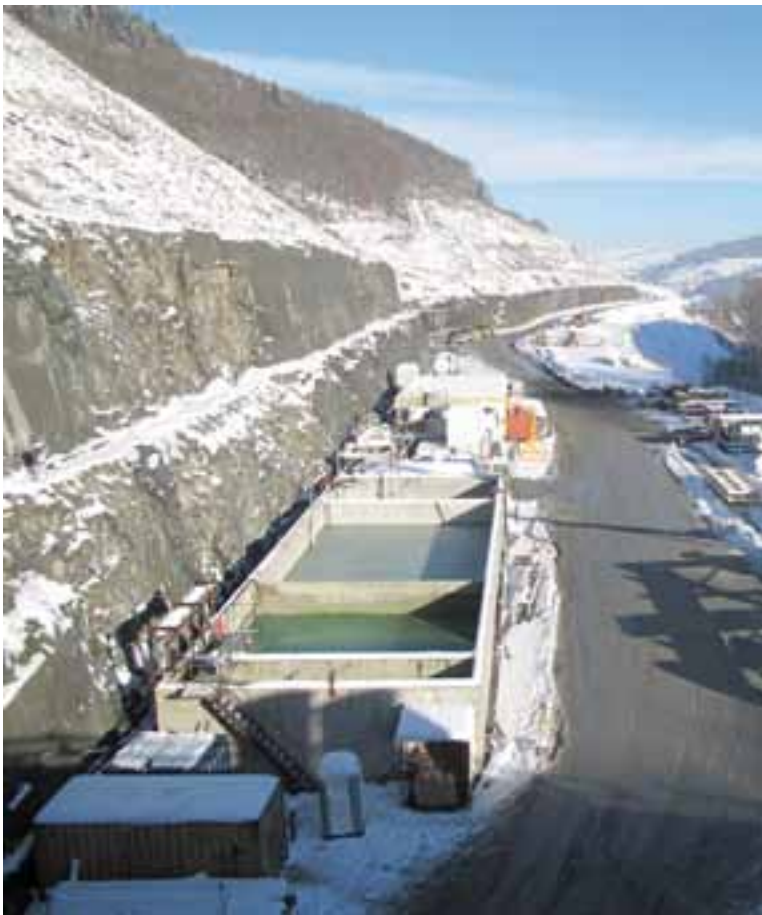
Tunnel de Violay : traitement des eaux d'exhaure.
