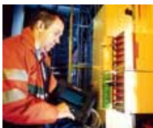
Des travaux de fibres optiques sont actuellement en cours de réalisation dans les Yvelines.
