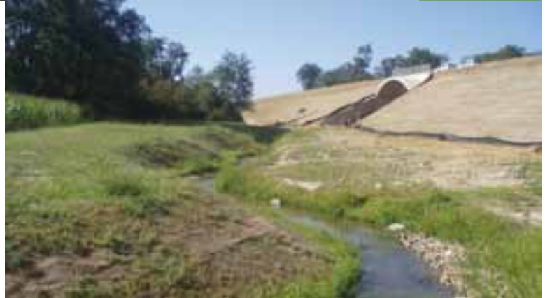
Un ouvrage cadre classique (type 3) rétablissant les cours d'eau.
