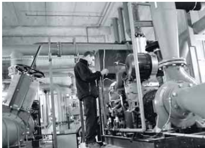
Local technique pour Sprinkler.
