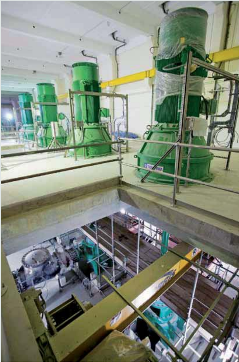
Doha (Qatar) – Salle de pompage et de transfert des eaux usées.
