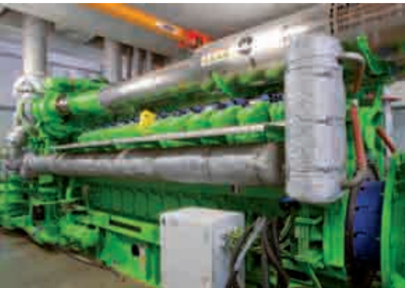
Centrale de cogénération de Vinet, destinée à l'alimentation de serres agricoles de 17 ha.
