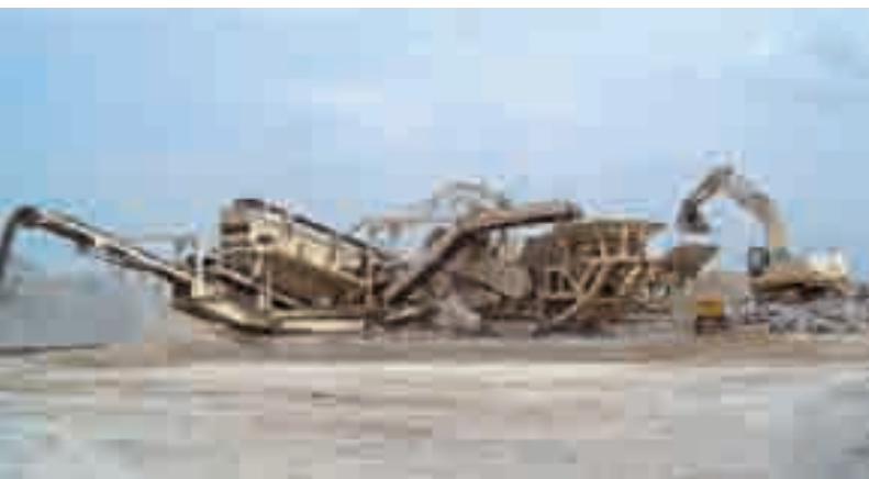
L'installation de concassage mise en place sur le site d'Aéroports de Paris lors de la création des aires de dégivrage (Eiffage Travaux Publics).
