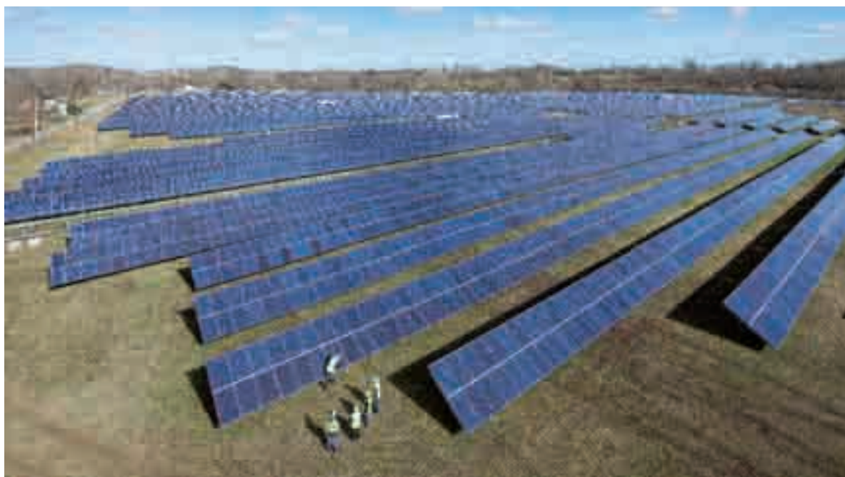
La ferme solaire (17 ha – 8 MW) de Villeneuve-de-Marsan (40) (Eiffage Énergie).
