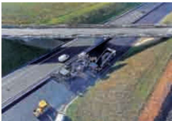
Pose de la Grave bitume GB5® sur le chantier de l'A49 (Eiffage Travaux Publics – APRR).
