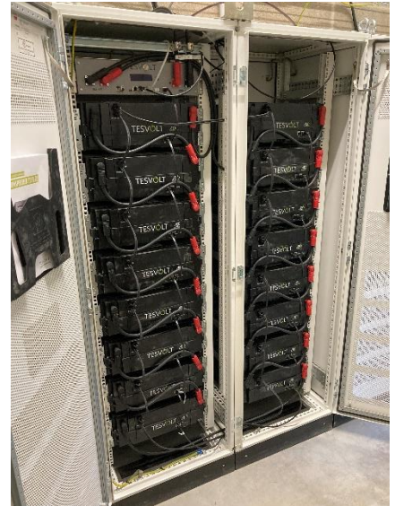
Batteries de stockage
