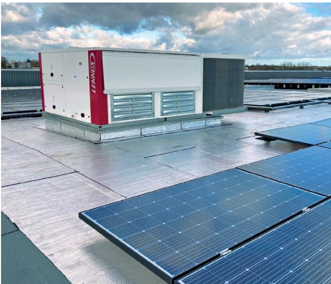
Pompes à chaleur air/air et centrale photovoltaïque
